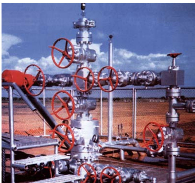
→ Armadura de surgencias, comúnmente llamada "árbol de navidad".
